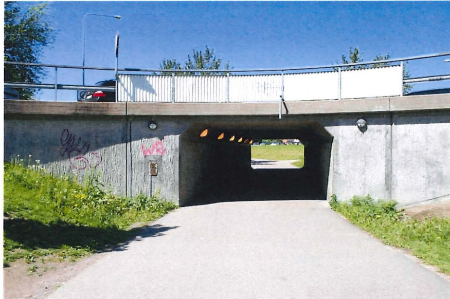
Figur 41: Gångtunneln under vägen till en av Vasaparkens hållplatser kan skapa otrygghetskänsla.
